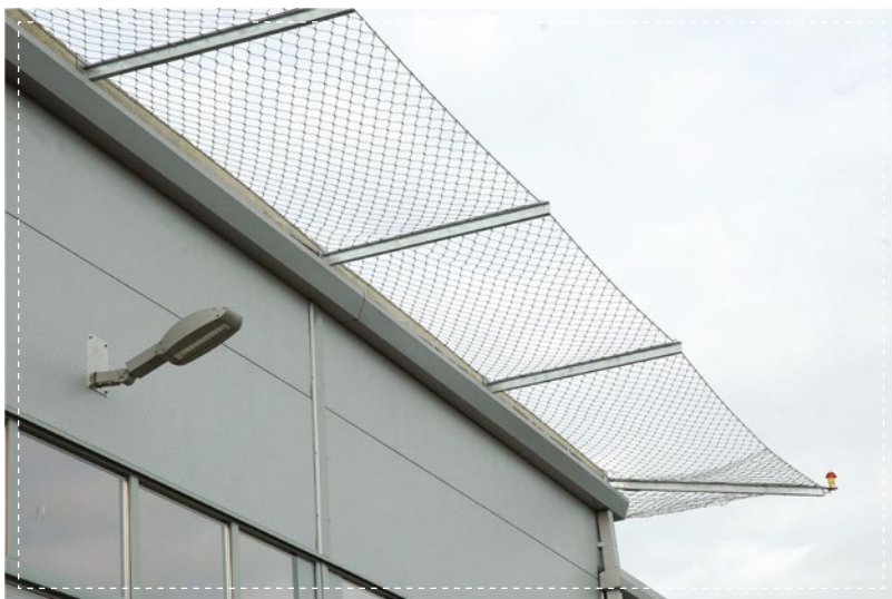
Siatka jako zabezpieczenie lądowiska helikopterów
